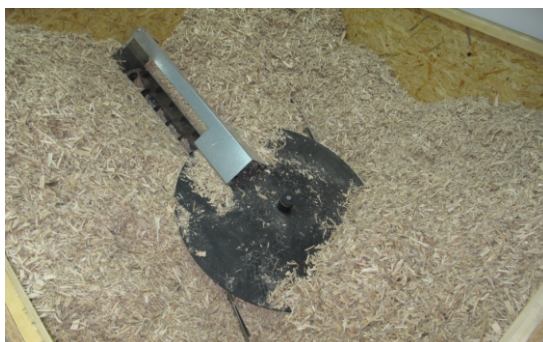
Spremnik sječke sa mješačem spojenim na transporter
