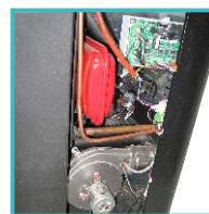
Ekspanzijska posuda, ventilator za odvod dima
