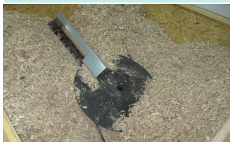
Prostorija/spremnik sječke sa mješačem spojenim na transporter
