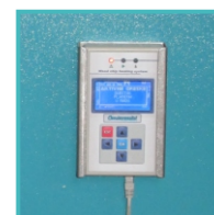
Digitalna kotlovska regulacija
